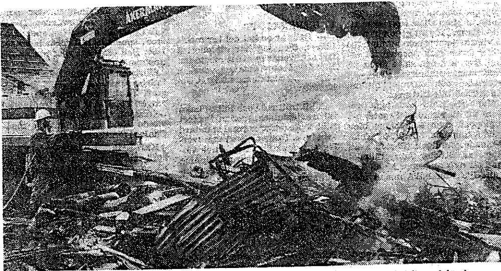
Lagerbyggnaden till Boxholms AB:s dörrfabrik totalförstördes vid en brand tidigt på lördagsmorgonen. Byggnaden var övertänd när brandkåren kom till platsen och ansträngningarna fick inriktas på att rädda den intilliggande produktionsbyggnaden. Saneringsarbetet inleddes redan på lördagen
