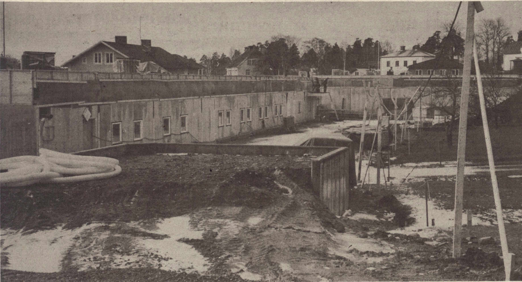
Det har gått fort med Centrumbygget i Boxholm. Nu återstår invändiga jobb och i juni invigs bygget.
