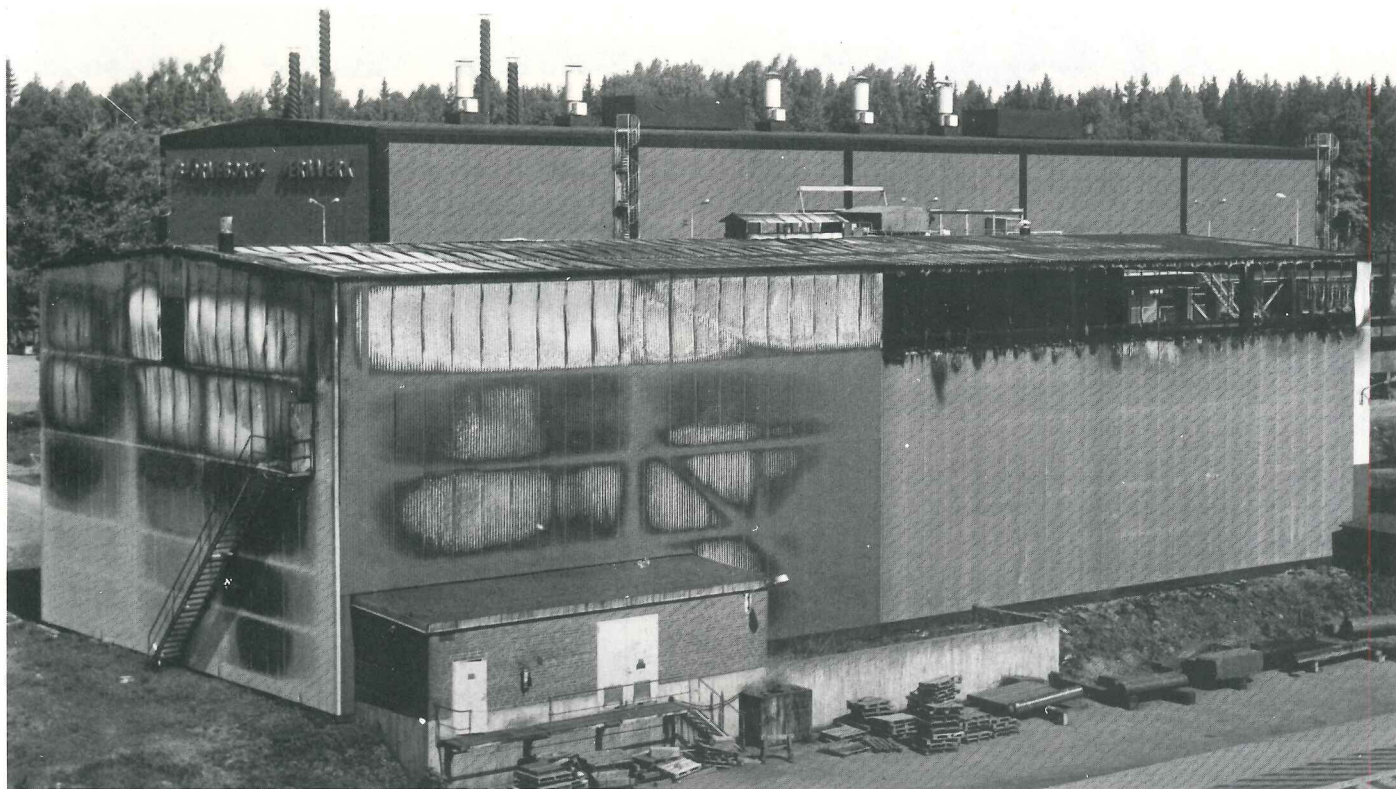
Den brandskadade byggnaden i Björneborg.
