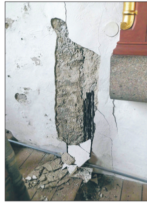
Här och var släpper putsen från kyrkans innerväggar på grund av att fukt trängt igenom alla lager med tegel.
