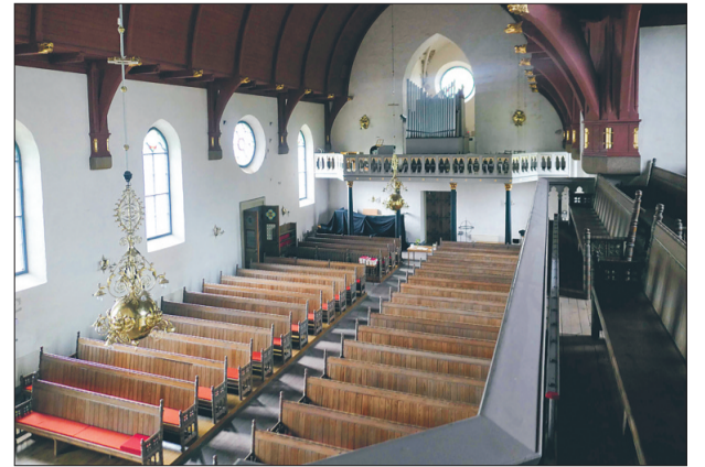
En bild från det stora kyrkorummet i Boxholms kyrka. Vid en hastig anblick kan det vara svårt att förstå kyrkans dåliga skick.
