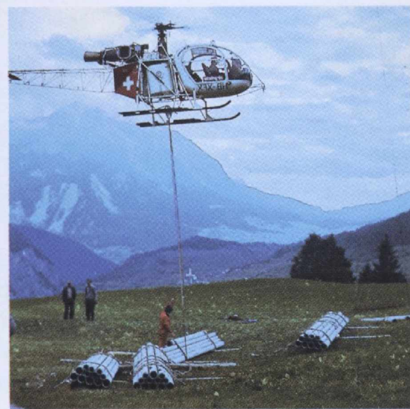
Rör till en skidanläggning i Alperna.
